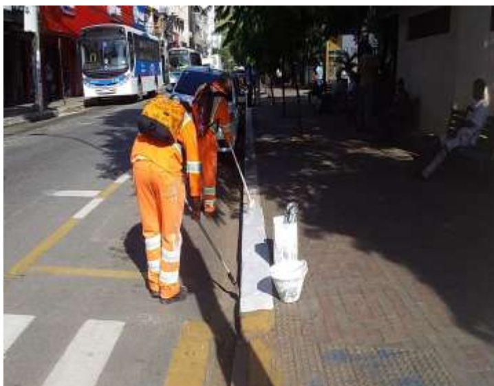
Figura 16 - Pintura de meio fio sendo executada no Centro de Barra do Pirai.
